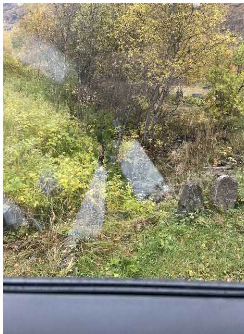
Figur 5-33: Innløp til stikkrenne. Området rundt er eroderbart og kan med fordel sikres.
