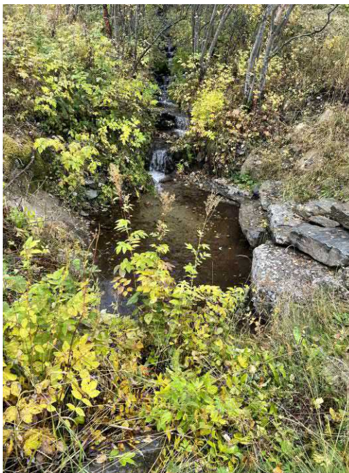
Figur 5-32: Innløp til stikkrenne.
