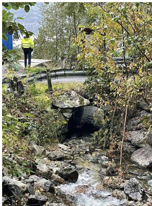
Figur 5-12: Stikkrenne i nedre del av Kvernagrovi er sannsynligvis underdimensjonert og med fare for tilstopping og erosjon mot grusvei.
