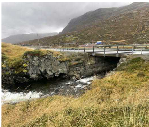
Figur 5-35: Veien er sårbar på kulvertens høyre side i bildet.
