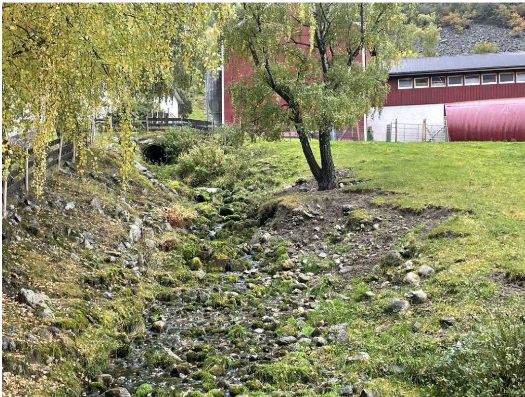
Figur 5-23: Delvis erodert skråning. Det piplet vann ut av området nedenfor treet under befarung.
