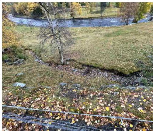
Figur 5-31: Erosjon langs dreneringsvei nedstrøms veien.
