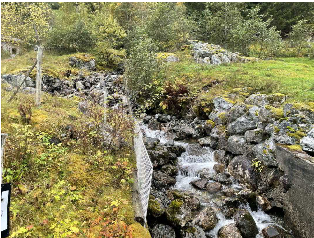
Figur 5-8: Oppstrøms kulvert ved Helland. En del oppsamlede masser i bekkeløpet.
